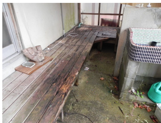
外廊下（要修理）
